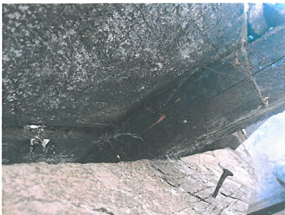
Particolare di altre travi non più idonee e sostituite
